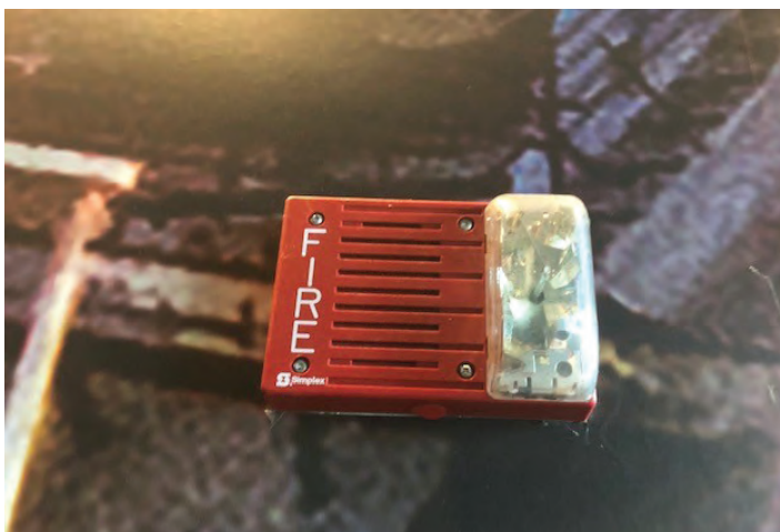
F1 - Cloudy Fire Alarm Device
